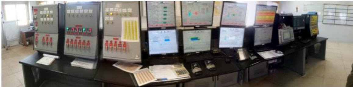
Figure II.8 : la salle contrôle de GS1 [14] .
