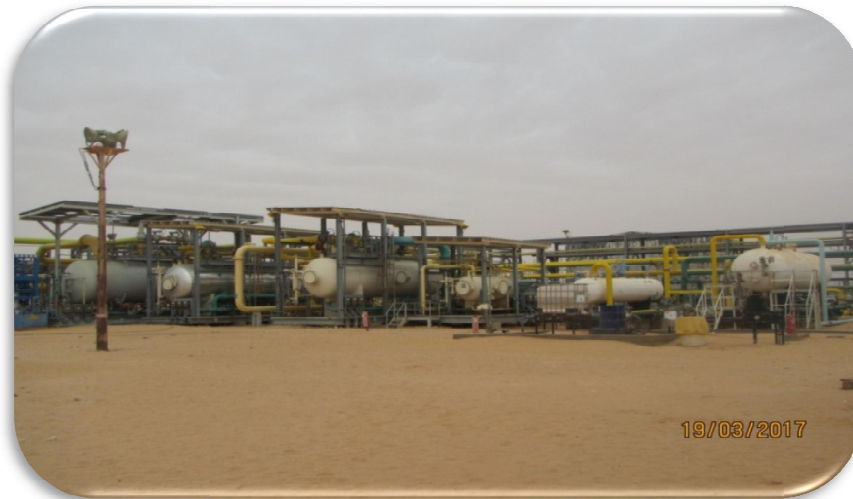
Figure III.14.a : les séparateurs de centre GS-1
