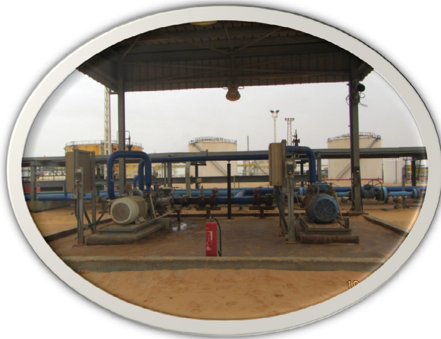
Figure III.20 : Pompe «booster» d'Eau Produite
