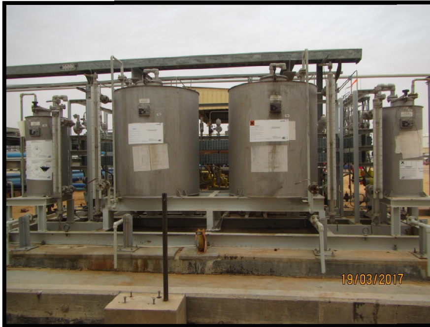
Figure III.22 : Les skids d'injection de produits chimiques.
