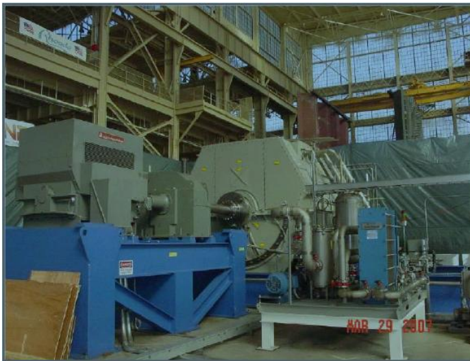
Figure 3.2. Plateforme d'essai AMSC – machine supraconductrice de 36.5 MW [24]
