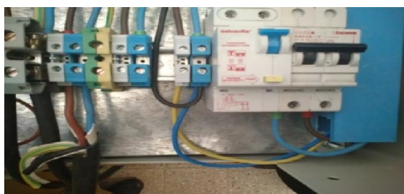
Fig. IV.3 Disjoncteur différentiel et les bornes
