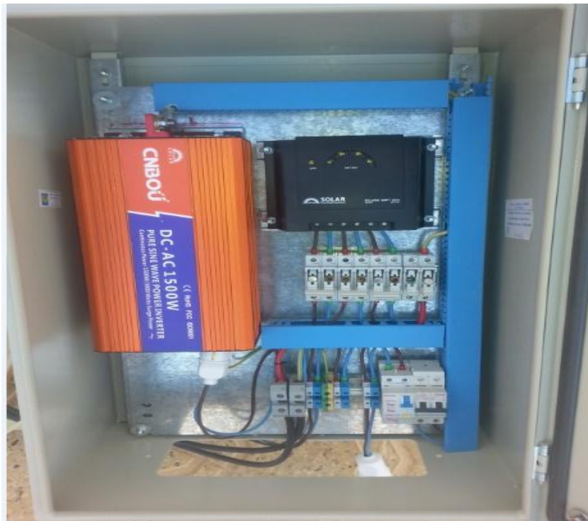
Fig. IV .5 Armoire électrique de commande
