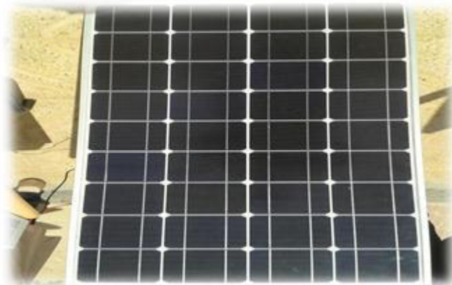
Figure 3.6: représente du module photovoltaïque étudié.
