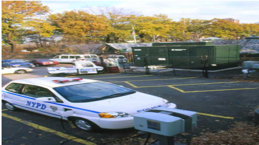
Figure I.12 : Piles à combustible de UTC à Central Park New York. [1]
