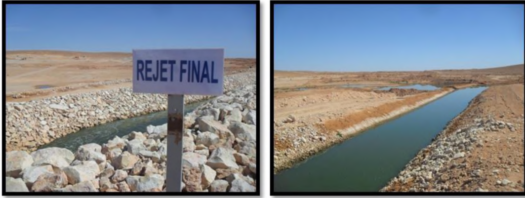
Figure II. 12 : Rejet final vers oued M'Zab
