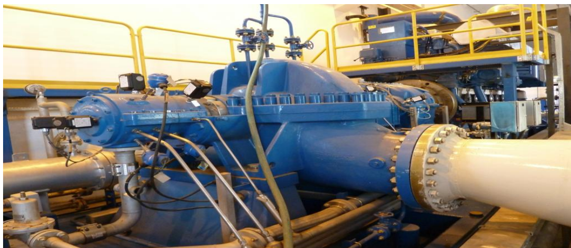
Figure (I.9) Station de pompage SP4 –Salle des pompes
