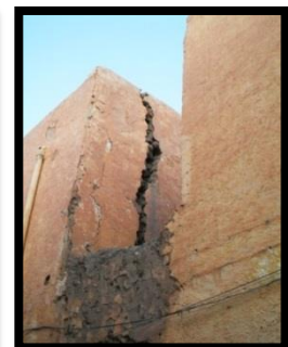
Photo N°13: Les fissures. /Source : l'auteur.
