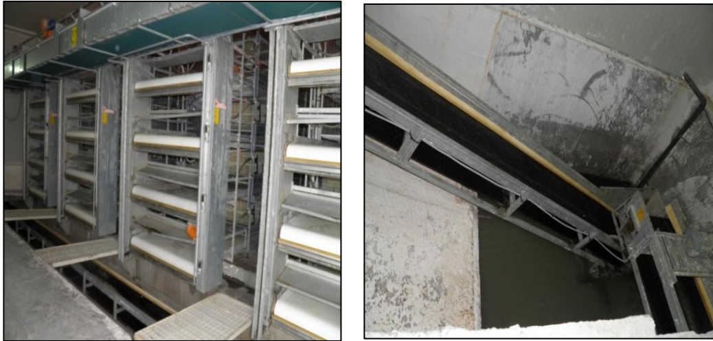
Figure 19et 20: Le chemin des fientes à l'intérieur du bâtiment(photo originale,2019)
