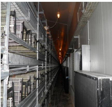
Figure 10 : Pad-cooling vue de l'intérieur(photo originale,2019)
