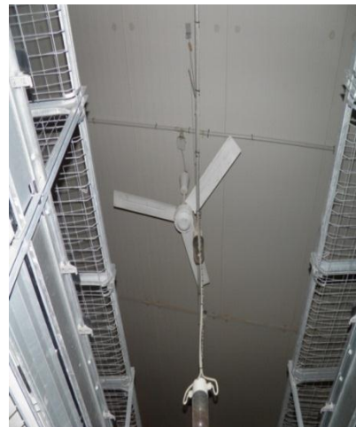
Figure 09 : Ventilateur au plafond(photo originale,2019).
