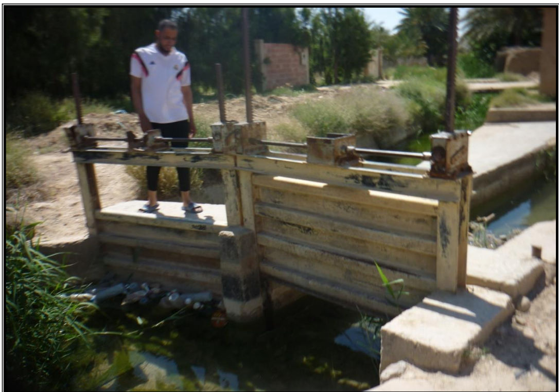
Fig.13. Porte d'eau (masraf). Ciment avec porte en métal-mécanique depuis l'époque coloniale. Originale
