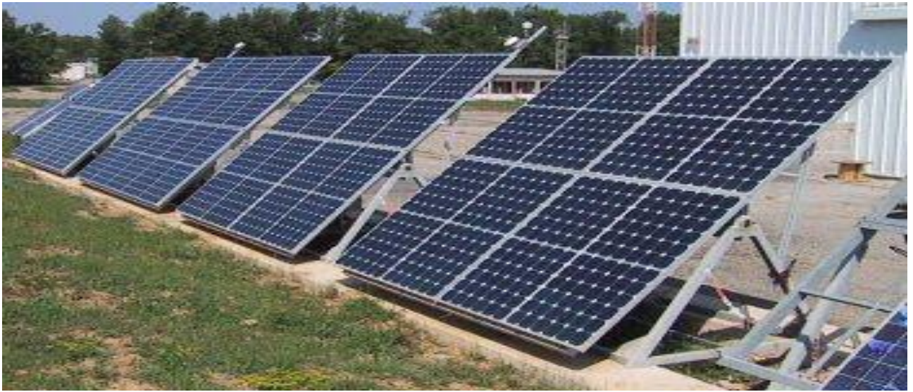
(Fig.I.12) : Panneau solaire.
