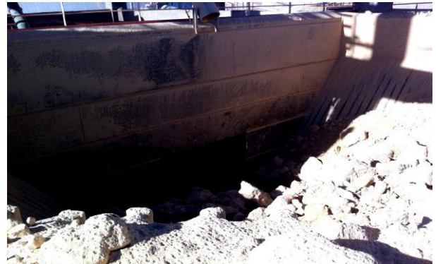
Figure I.4 : La trémie de concasseur.
