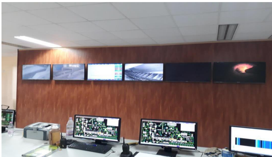
Figure I.22 : La salle de contrôle.
