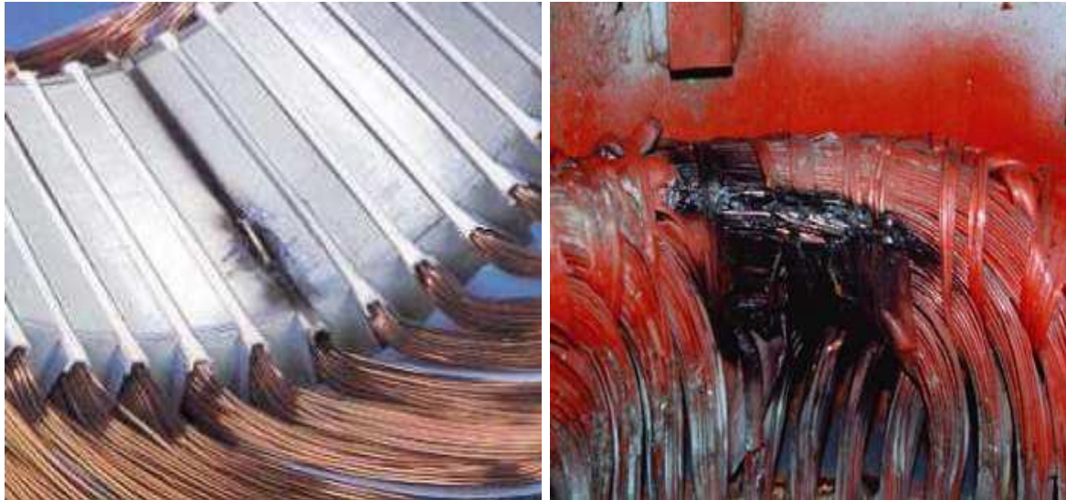
Fig. I.7 : Exemples de dégâts dus au défaut de court-circuit statorique d'un MAS [3].
