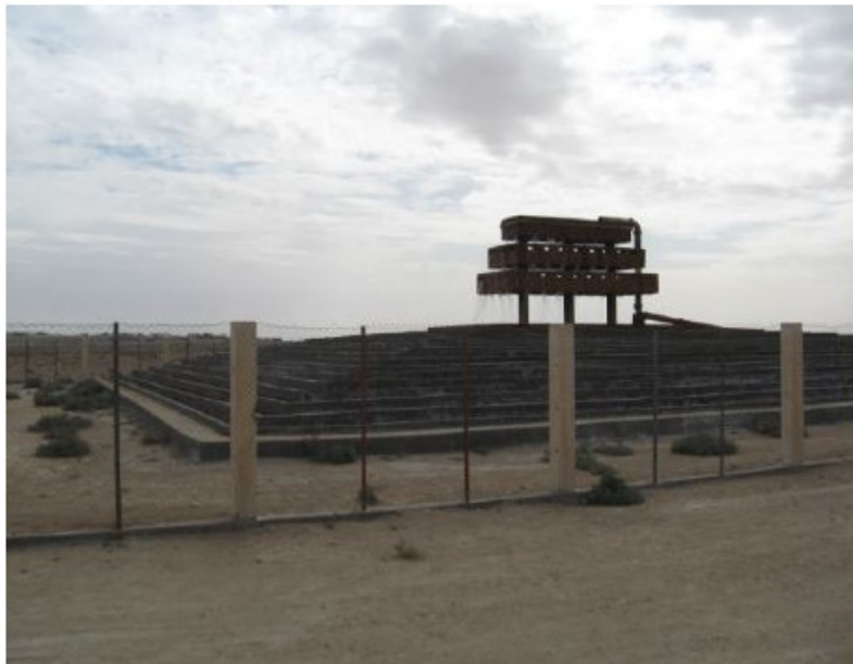
FIGURE 2.21 – Système de refroidissement des eaux par cascade.
