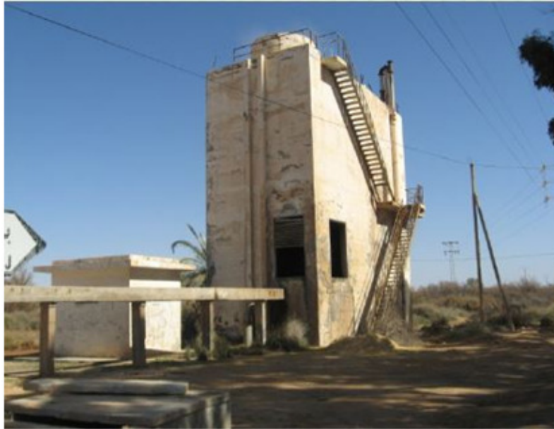
FIGURE 2.18 – Tour de refroidissement.
