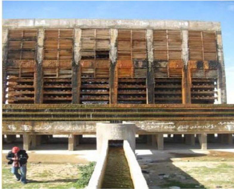
FIGURE 2.20 – Système de refroidissement des eaux par cascade.
