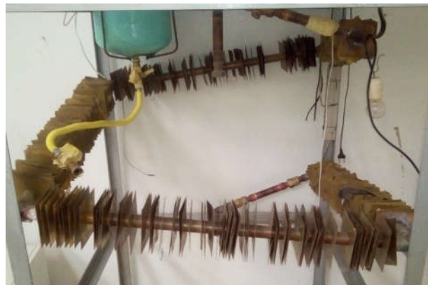
Figure 2.21. L'ancien condensateur déformé.
