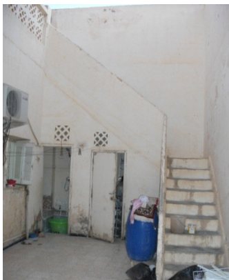
Avant : Escalier mal façonné et non exposé à l'utilisateur
