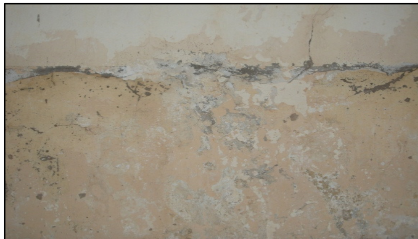
Photo 34 : présence de salpêtre Source : auteur 2019
