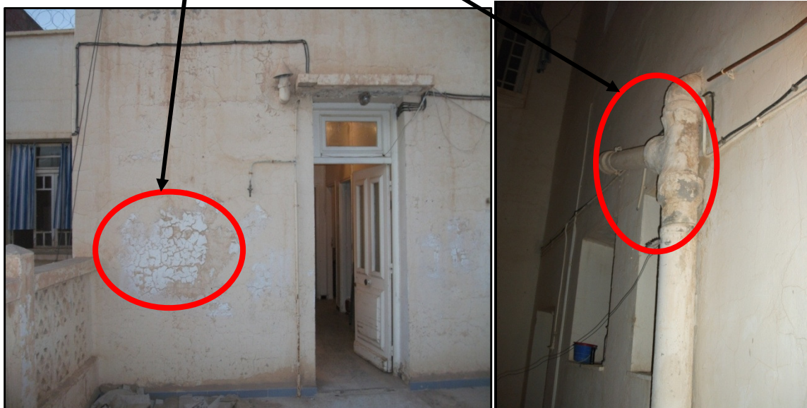
Photos 33 : Présence d'humidité au 1er étage.
