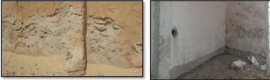
الشكل98: بعض الصور الخارجية لجدران المبنى تظهر مدى تأثرها من ظاهرة التكتف حيث نلاحظ تآكل وتشوه الجدار من الخارج.
