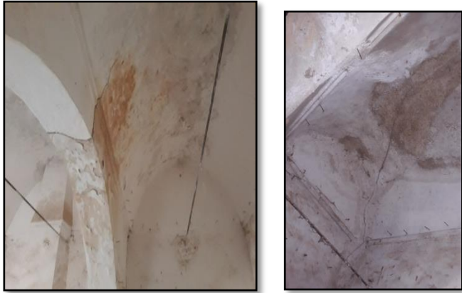
الشكل97: صور داخلية للعقود توضح تسرب المياه
