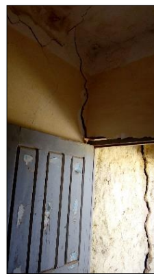
Fig. 130 : Fissures passantes. Source : Auteur 2019
