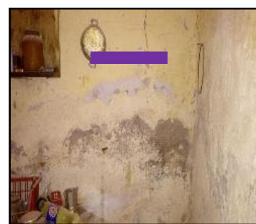
Fig. 124 : L'efflorescence Source : Auteur 2019.
