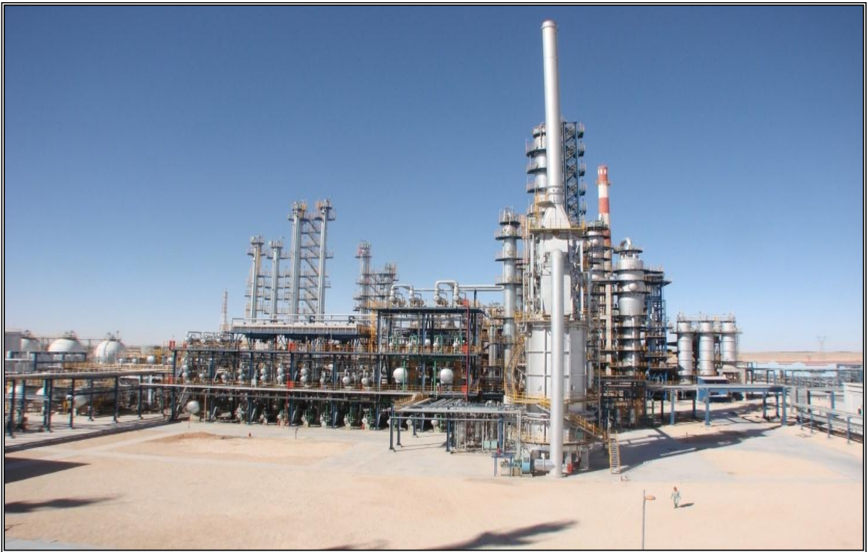
Figure .1.14 Vue de l'unité de distillation atmosphérique
