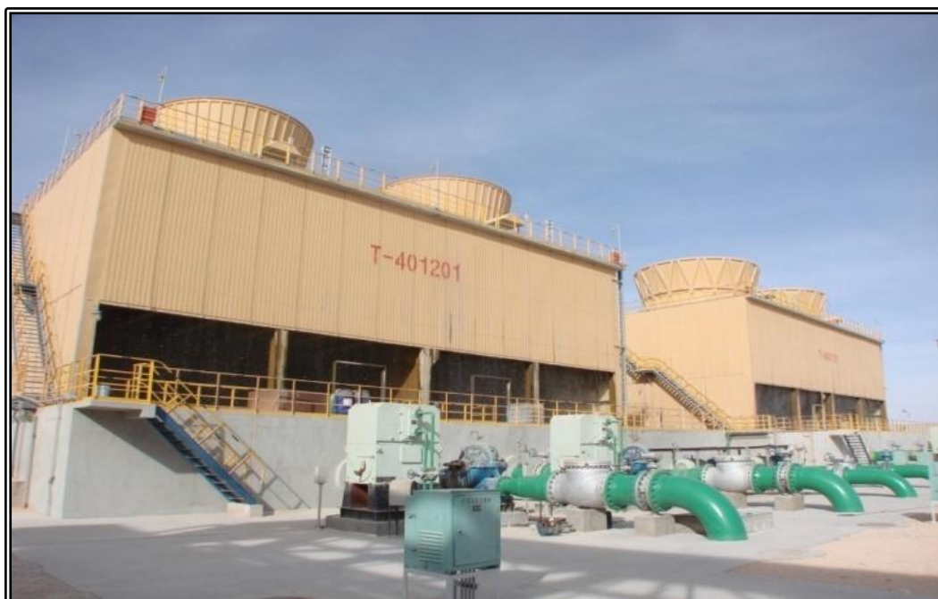
Figure 1.12 Tour de refroidissement d'eau
