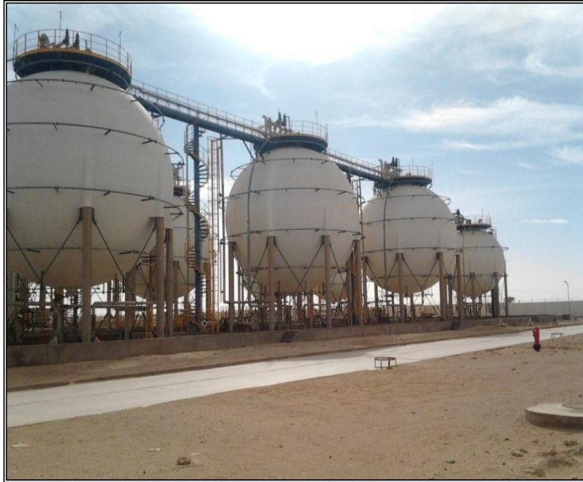
Figure.1.17 Sphères de stockage gaz
