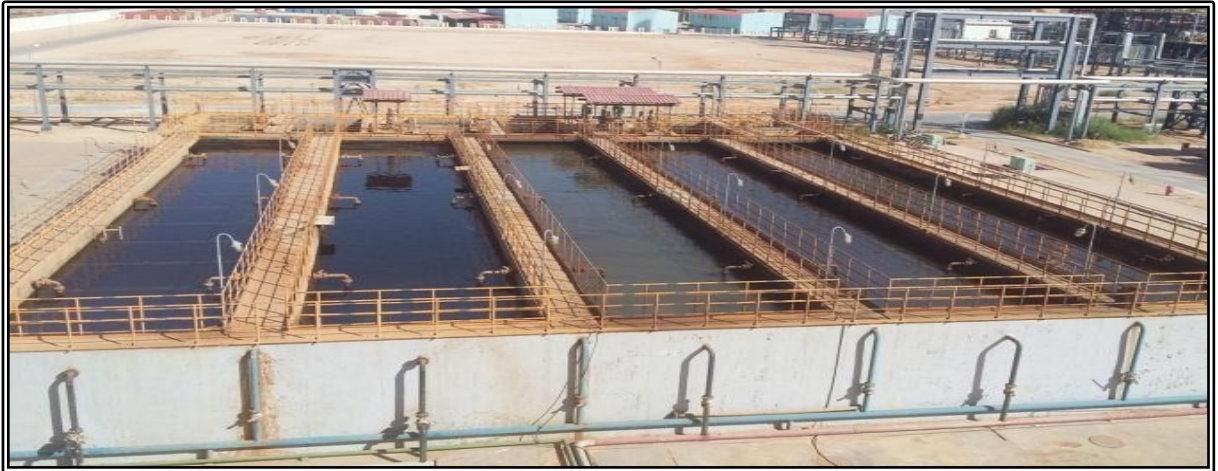
Figure. 1.13 Bassin de traitementdes eaux usées
