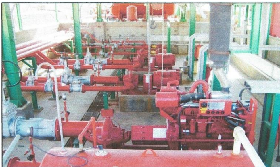
Figure I-14 : La centrale anti-incendie. [7]
