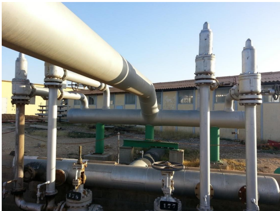
Figure I-4 : Soupapes de sécurité.
