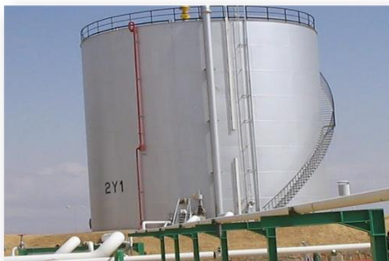
Figure I-12 : bac de détente à toit fixe.
