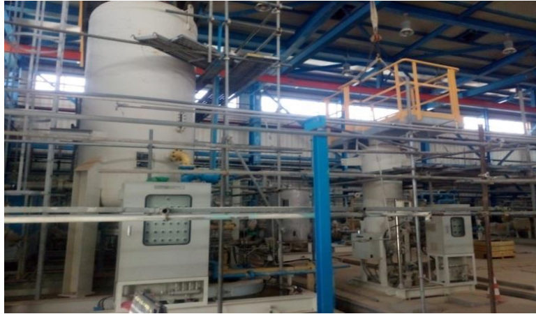
Figure I-3: Station de traitement des eaux.
