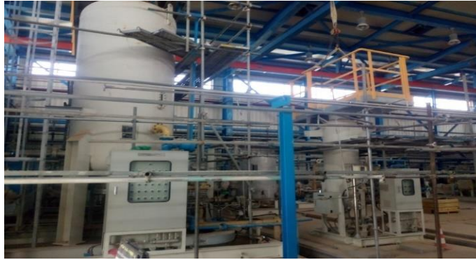
Figure I-5: Station de traitement des eaux.
