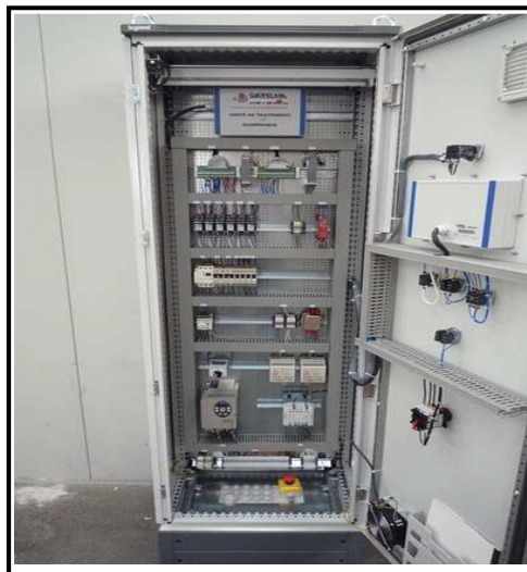
Figure III .8: L'armoire électrique du doseur. [14]
