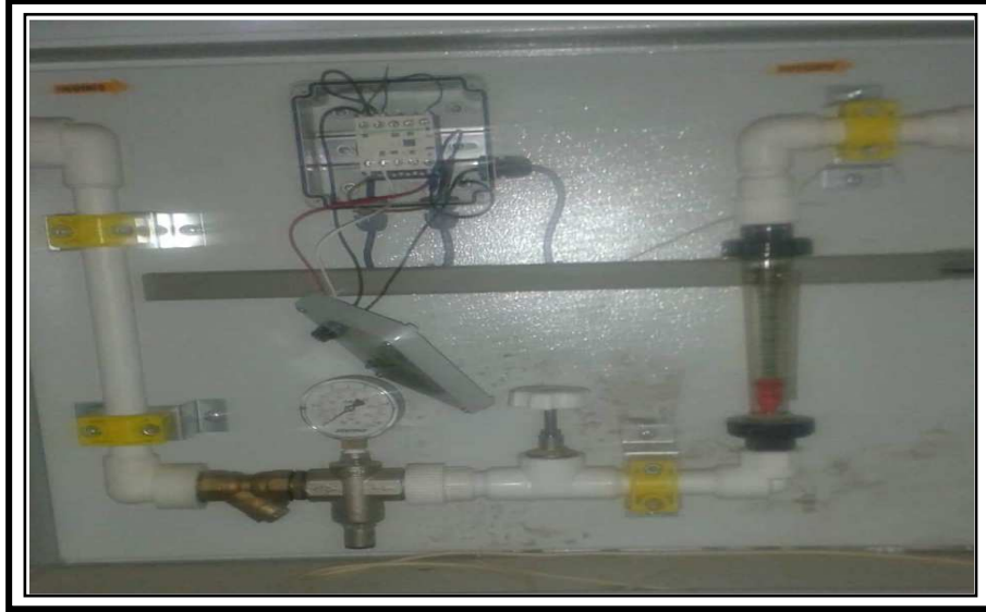
Figure I.7: L'armoire électro-hydraulique de système existant dans l'usine.
