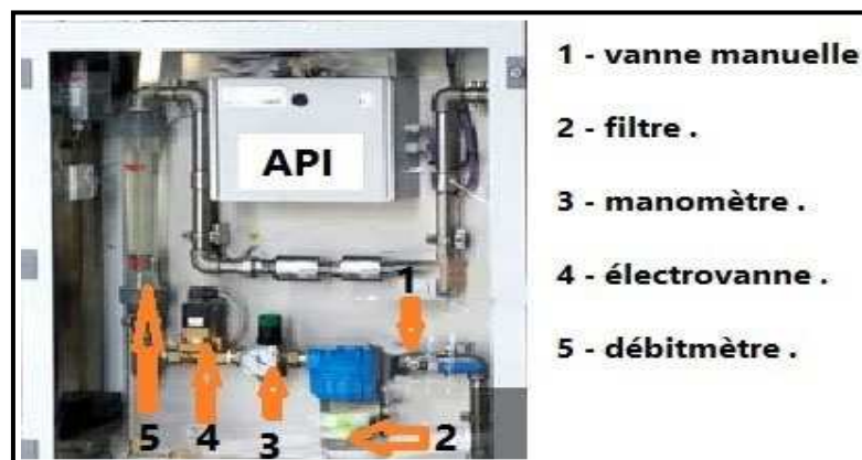
Figure III .1 : L'armoire électro-hydraulique de système contrôle d'humidité.
