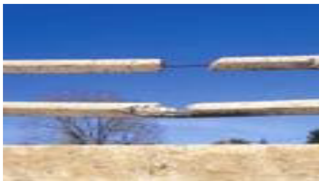
Figure I.4: Barrières de retenue dégradée
