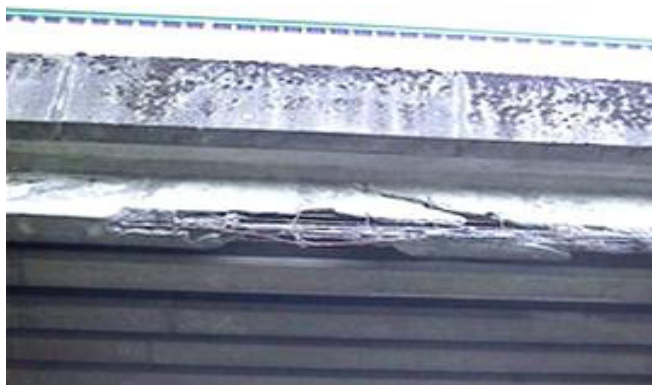
Figure I.3: Intrados des ponts dégradés
