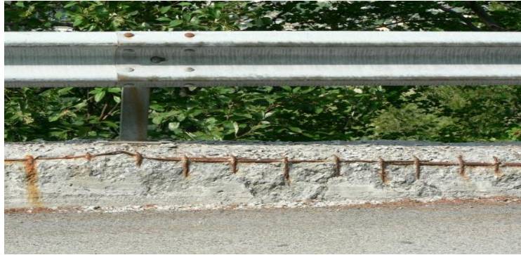
Figure I.7 : Corrosion des armatures consécutive à la fragilisation du béton d'enrobage et à l'utilisation des sels de déverglage.
