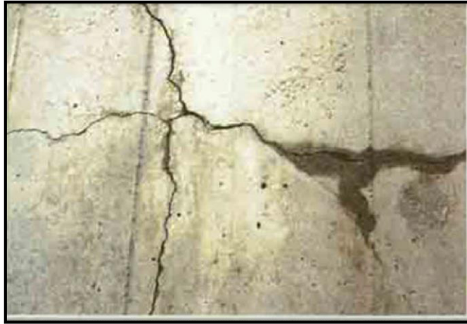
Figure I.23: Fissuration en étoile de plusieurs millimètres d'ouverture du la réaction alcali-granulat [27].
