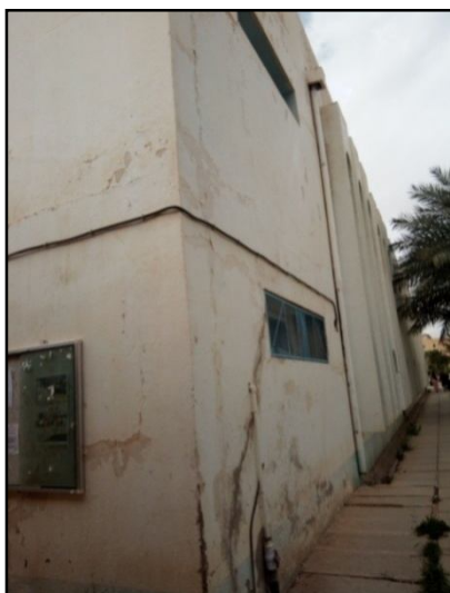
Cas (1-H) -d- Fissure à l'inférieure de mur Et tracé d'humidité
