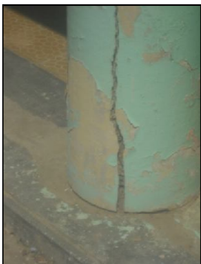
-a-Fissure à la base de poteau
