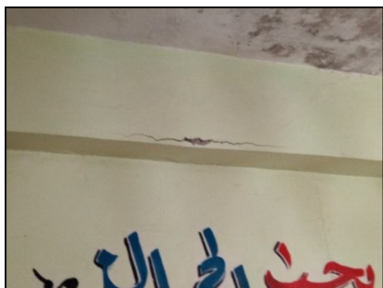
-a- Fissure au semi de la poutre
