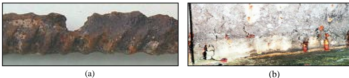
Figure I-8 : Conséquences de la corrosion par chlorures. [1] -[9]
