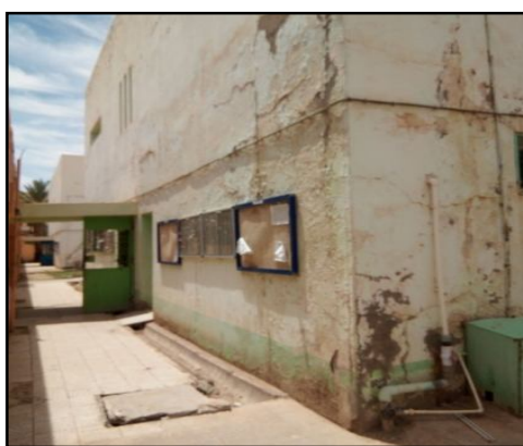
-a- Vue générale : infiltration d'eaux
