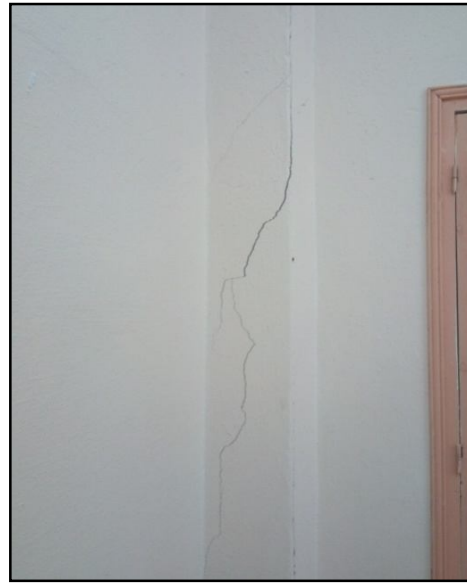
-b- Face avant de la fissure
