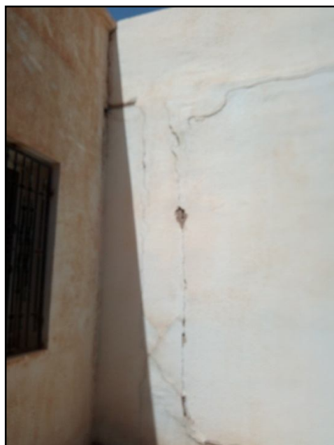
-b- Fissure traversant, face extérieur
