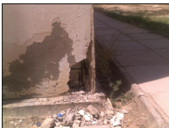
-a- Dégradation à la base du poteau en 2011
