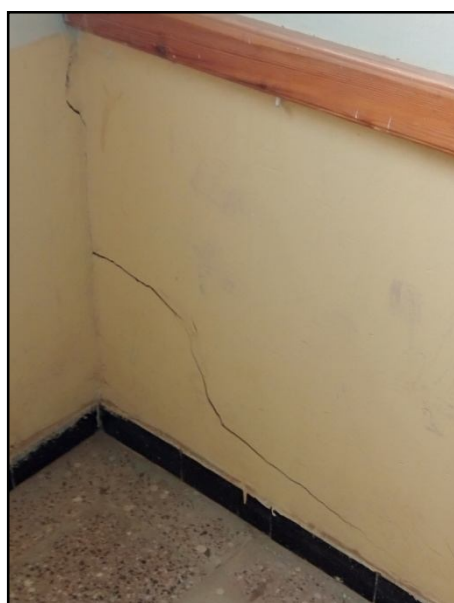
Cas (1 -H)-c- Fissure oblique dans un mur intérieur Coté avant
