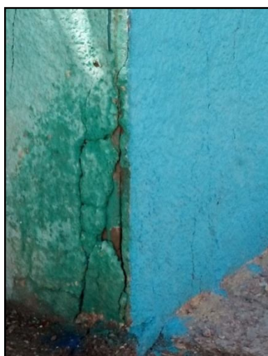
-a- Vue générale dégradation à la base du poteau
