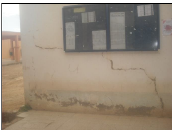
Cas (1 -H) -a- Fissure oblique dans un mur extérieur
