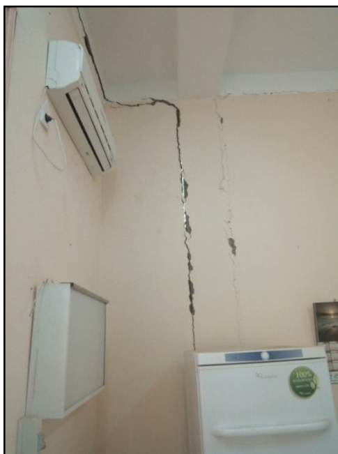
-a- Fissure traversant, séparation de paroi
