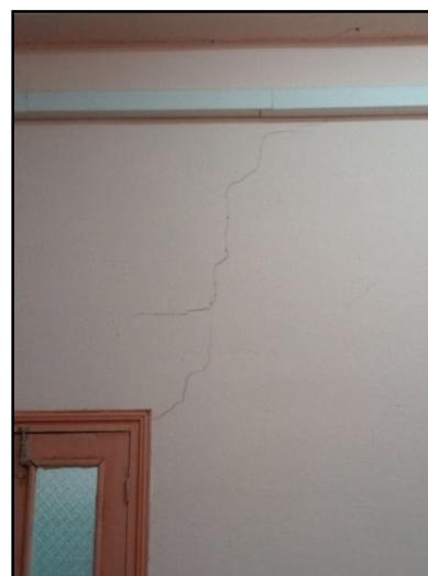
-b- Fissure à haut de porte
