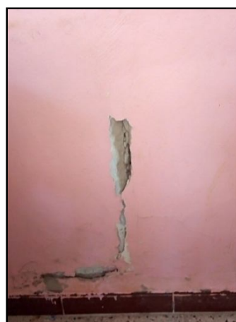
-c- Fissure et corrosion
