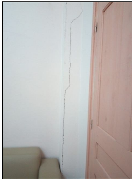
-c- Face latérale de la fissure
