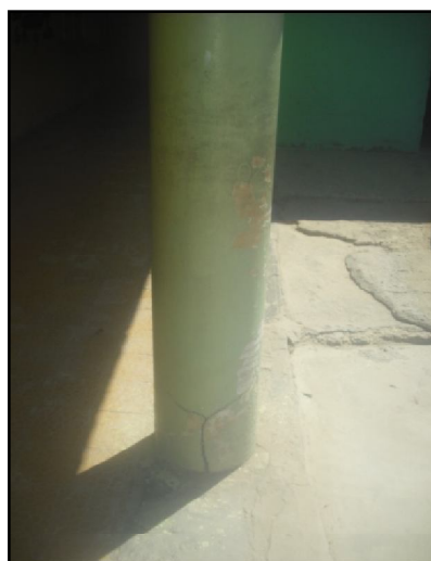
-b- Poteau fissuré
