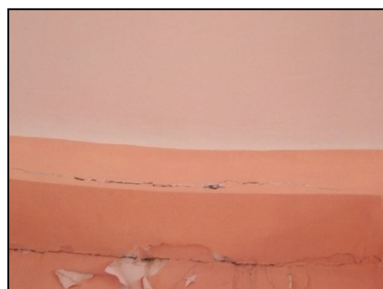
-b-Fissure à la long d'armature et trace d'humidité
