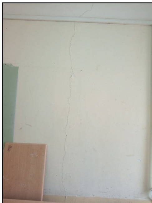
Cas (1-H) -a- Fissure verticale dans le mur intérieur
