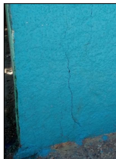
-b- Fissure à la face latérale
