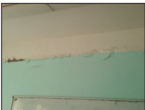
-d- Craquelage à la long de la poutre
