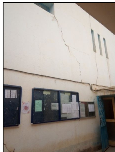
-e- Fissure sous la fenetre au niveau d'étage
