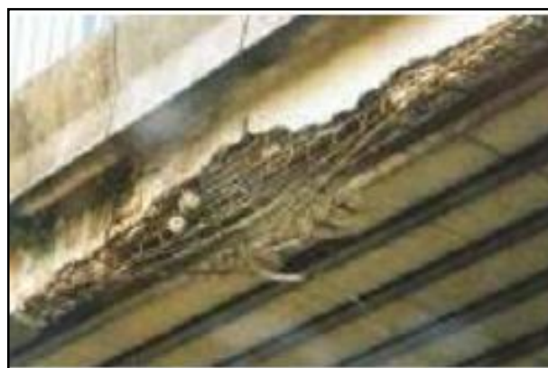
b. Dégradation de l'extrados d'un pont du au choc des véhicules
