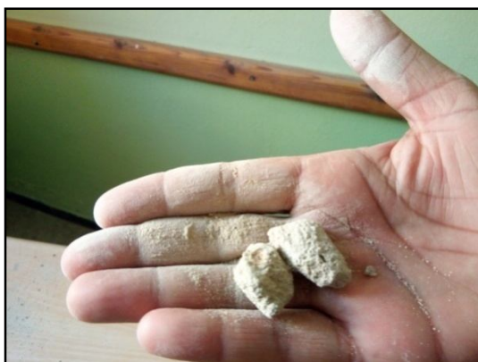
-c- Mauvaise mortier
