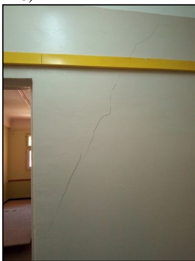
-a- Fissure oblique : Face extérieur
