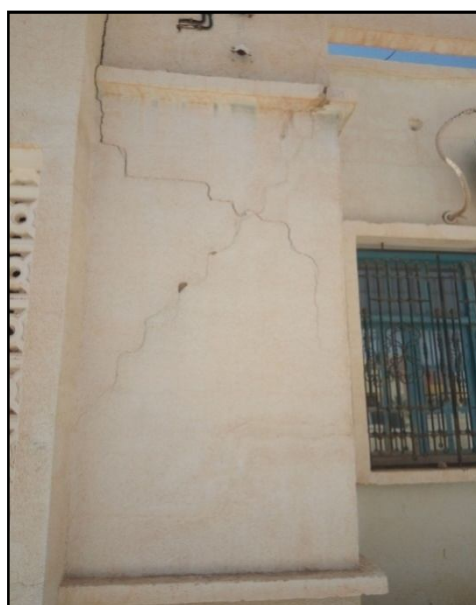
Cas (1-L) -c- Lézarde dans un mur extérieur
