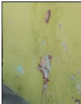
-b- Face latérale au poteau dégradé
