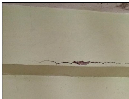
-b- Fissure à la long de la poutre
