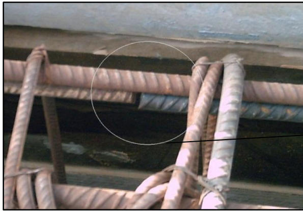
(c) Ferrailages trop courtes au niveau de recouvrement
