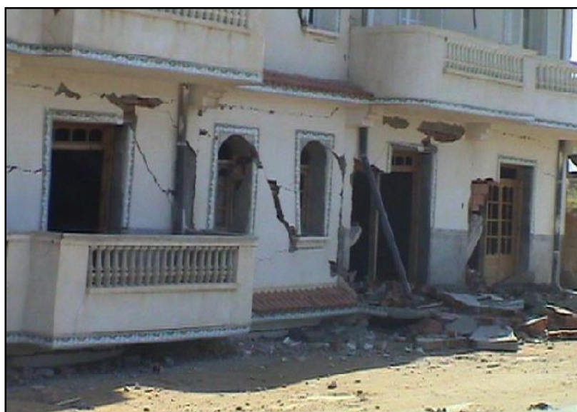
Figure I-21 : Effondrement complet de RDC (Étage souple) [13]
