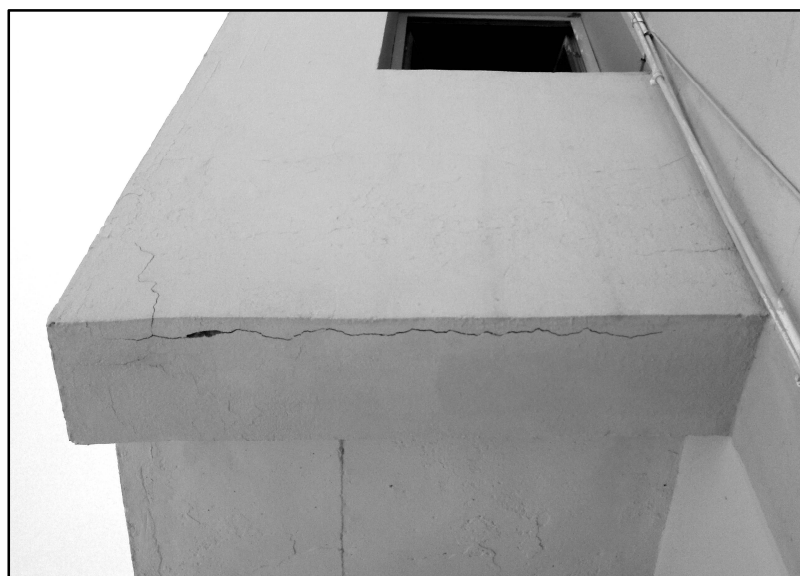
-a- Fissure à la long d'armature
