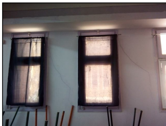
Cas (1-C) -c- Fissure à haut de fenêtre
