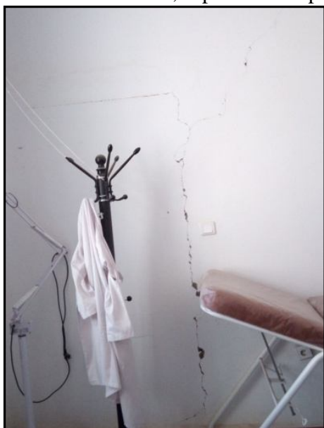
-c- Fissure traversant, séparation de paroi
