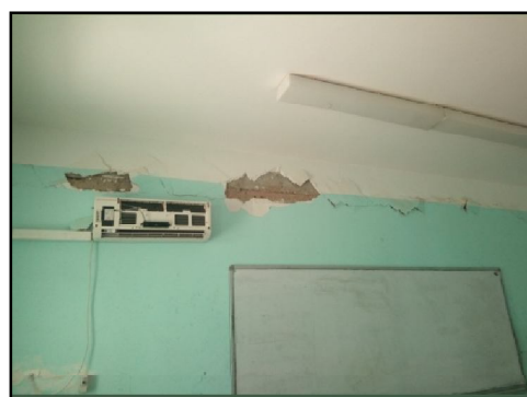
-c- Décollement à la long de la poutre
