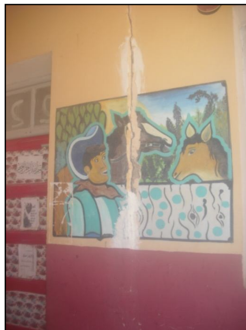
Cas (2-A) -b- Fissure verticale dans le mur intérieur
