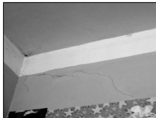
-d- Fissure oblique : Face intérieur de paroi
