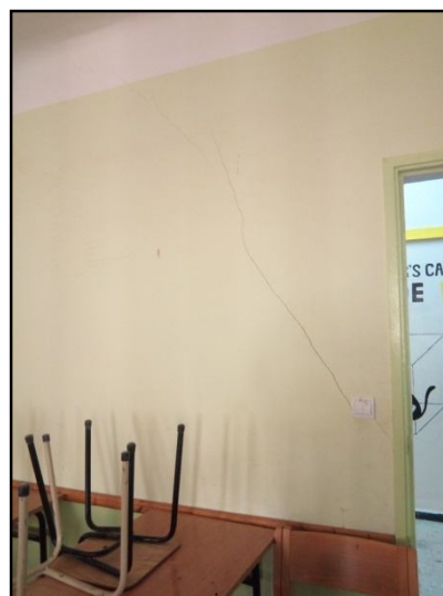
-b- Fissure oblique : Face intérieure de mur
