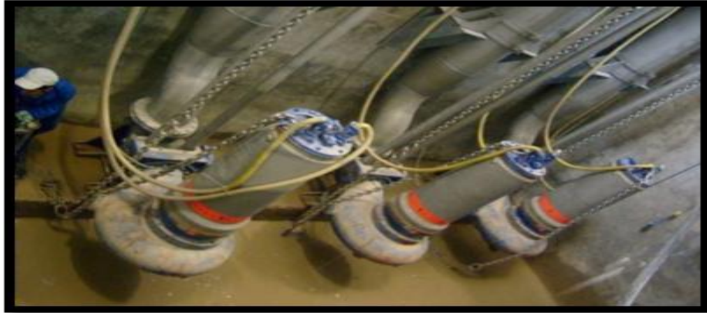
Figure n°21 : Station de relevage es eaux brutes de la STEP Tiaret.
