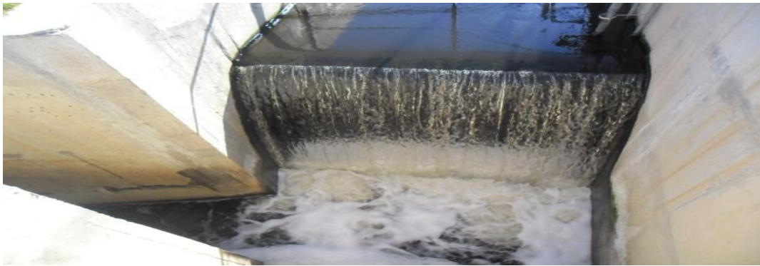
Figure n°25 . Rejet à la sortie de la STEP des eaux épurées.
