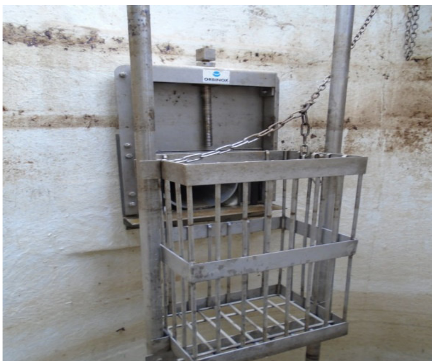
Figure 3.18 : un dégrilleur de type panier dégrilleur en acier inoxydable (hydro-technique).
