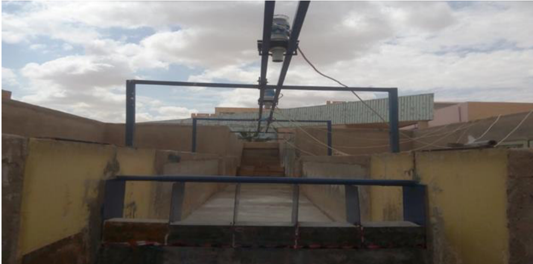
Figure III.9 Détecteur de niveau à ultrason au niveau du canal.
