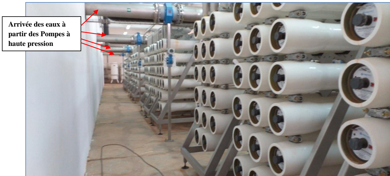
Figure 32 : Modules de l'osmose inverse au niveau de la station, (Photo: Lakhdari –H Le : 14/02/2019).
