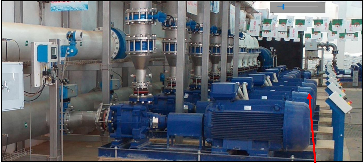
Les 05 Pompes à haute pression
