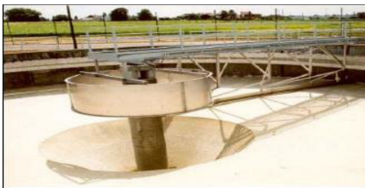
Figure I. 2 : Décanteur primaire avec pont racleur a engrainement périphérique (Deshayes, 2008).
