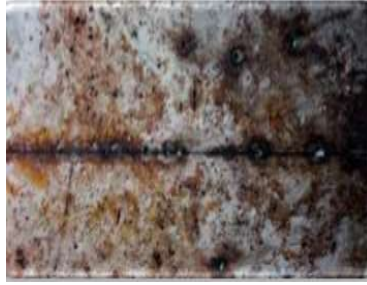
Figure (I.3) : corrosion par piqûre dans une paroi
