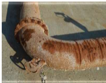
Figure(I.1): la corrosion uniforme dans une pipe de transport.
