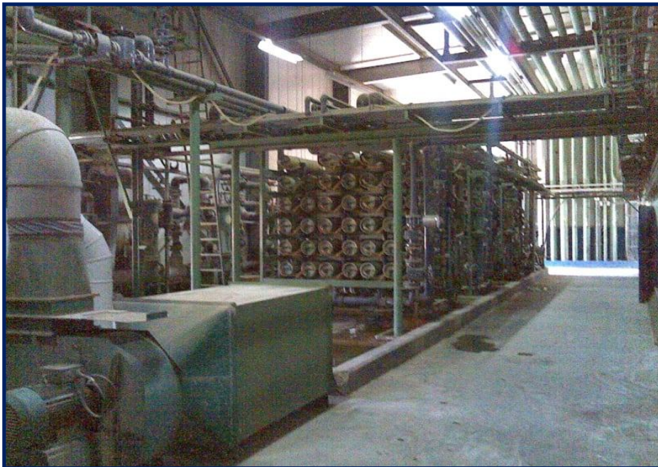
Figure III.10 : Photo des 3 Blocs d'osmose inverse (station de traitement des eaux, TIFIB 2013)
