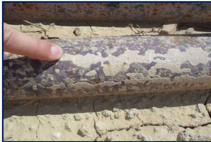
Figure II.11 : Photo des dépôts (tartre) sur un tube de fumée
