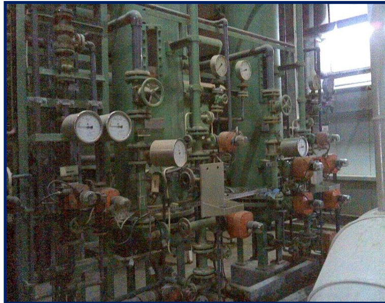
Figure III.12 : Photo deux Adoucisseurs industrielles de type cationique (TIFIB)
