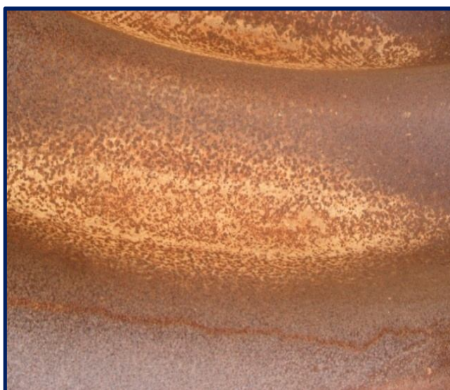
Figure II.13 : Photo de corrosion du foyer dans une chaudière
