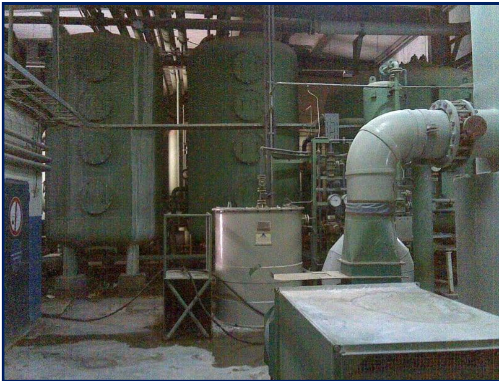
Figure III.3 : Photo d'un Filtre à 2 matières (Sable – Charbon actif) TIFIB
