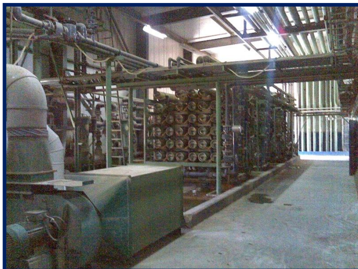
Figure IV.3 : Les trois blocs d'osmose inversée (TIFIB)
