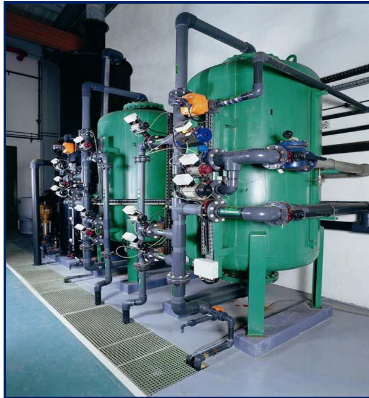
Figure III.1 : Photo d'un Filtre à sable
