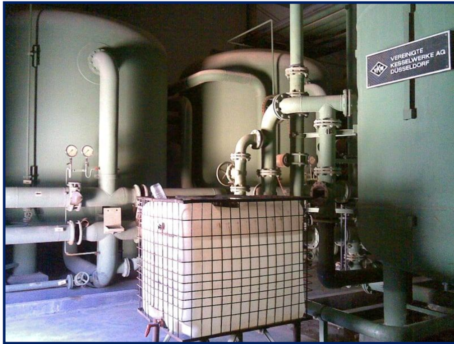
Figure III.2 : Photo d'un Filtre à charbon actif (TIFIB)
