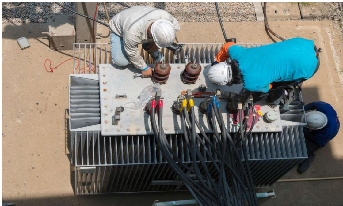
Fig (I.2) : Opérations de maintenance sur transformateurs
