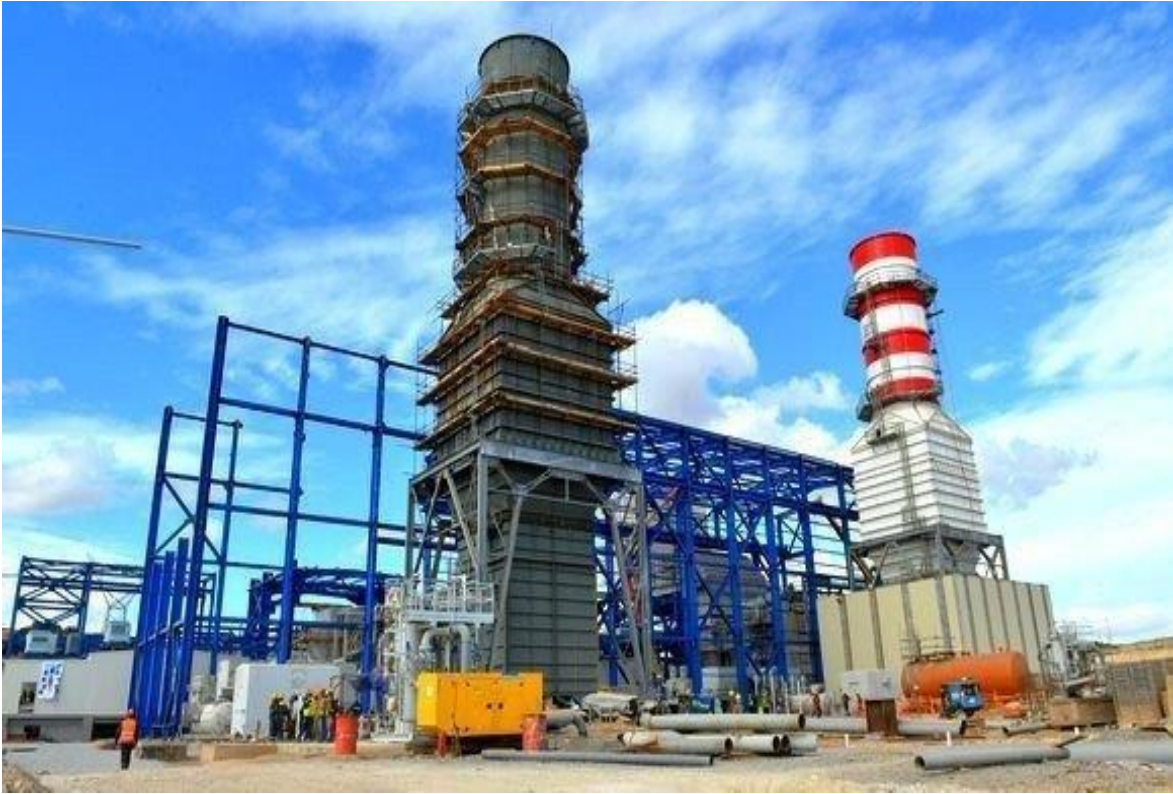
Fig (III.1) : la base d'électricité Ouméche
