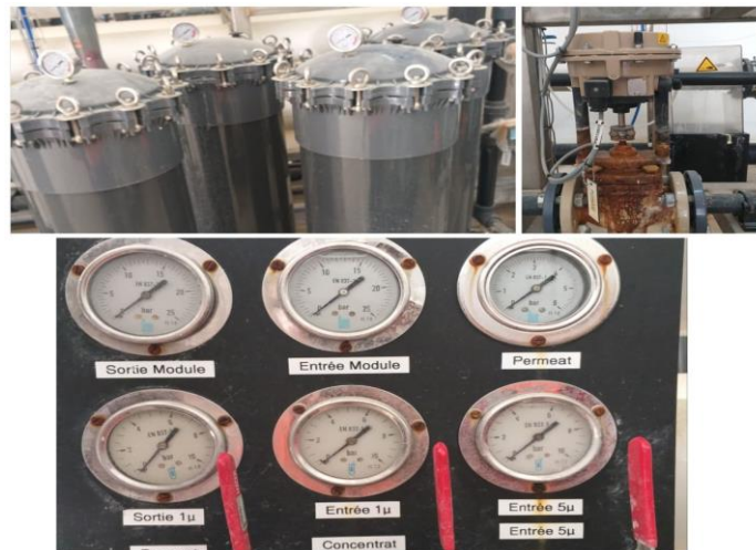
Figure (3.4) : Le système de dessalement de la cimenterie CILAS Biskra
