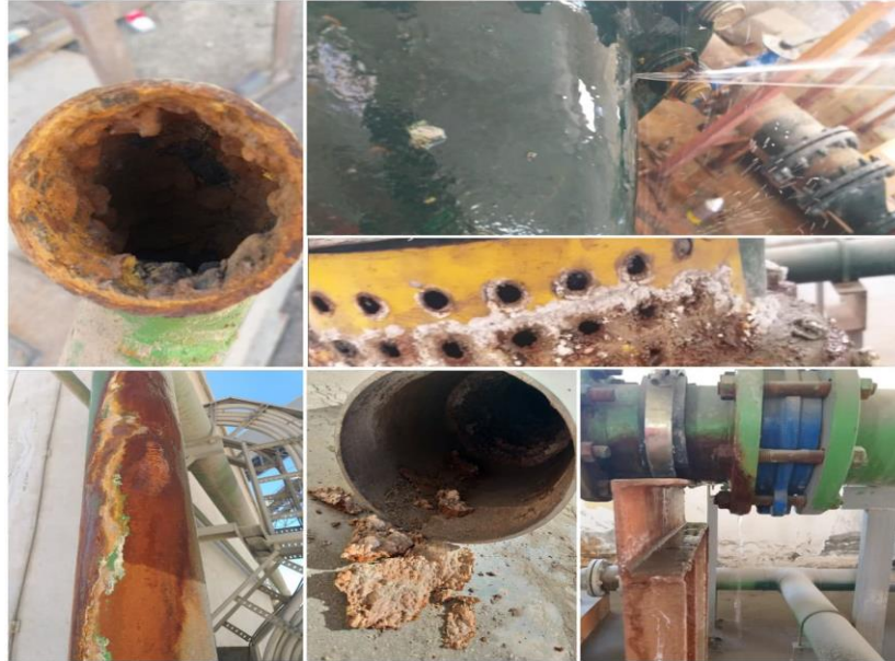
Figure (3.3) : Le phénomène de corrosion dans la cimenterie CILAS Biskra.
