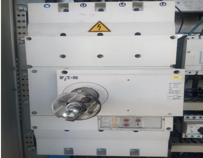
Figé.II.3. Disjoncteur sectionnaire.
