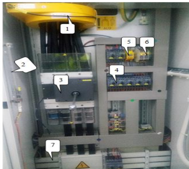
Fig.III.13.L'armoire électrique de la commande de la machine souffleuse.
