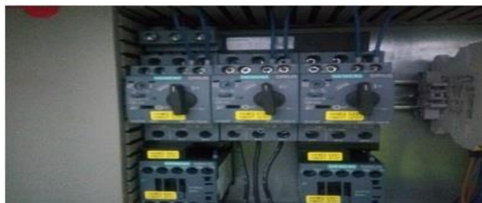
Fig.III.6. L'appareillage de protection par Disjoncteur de puissance Siemens.
