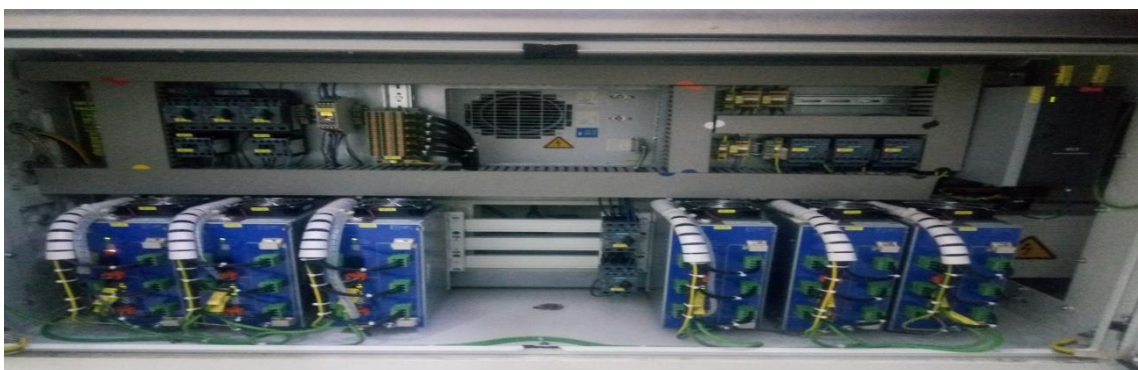
Fig.III.4.L'armoire électrique pour la commande du four.
