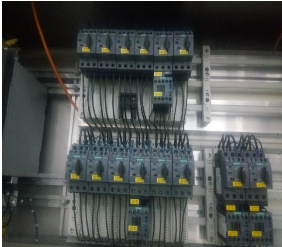
Fig.III.19. Disjoncteur de puissance.
