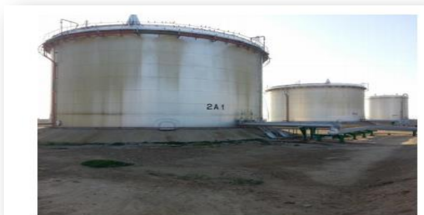
Figure I.7. les bac de stockage.
