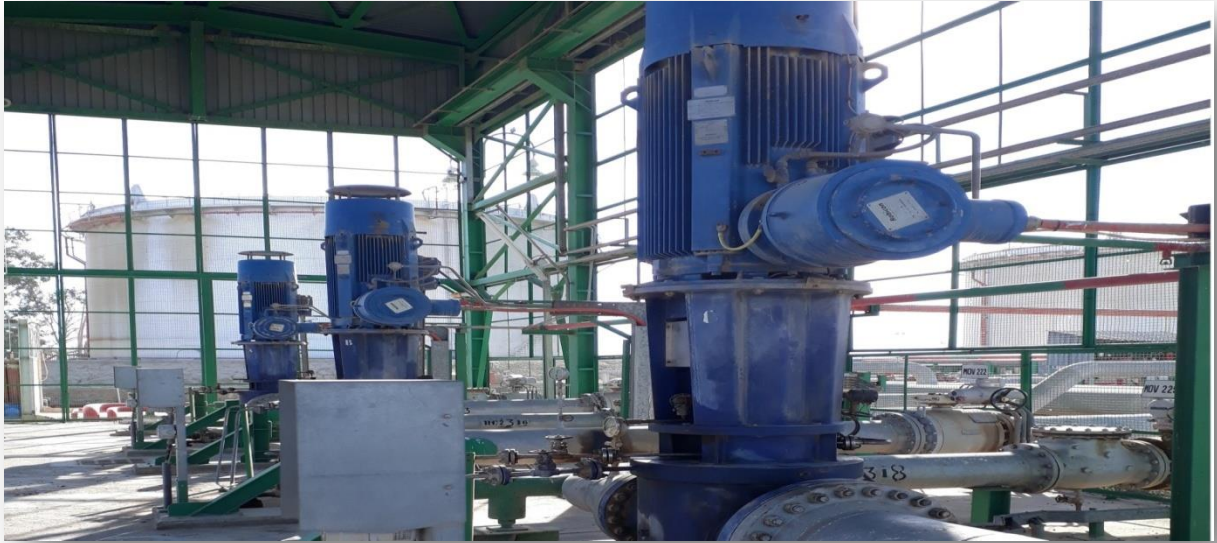
Figure I.9. les pompes booster.
