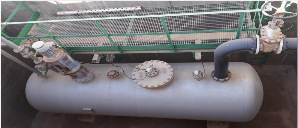
Figure I.8. Réservoir de purge.
