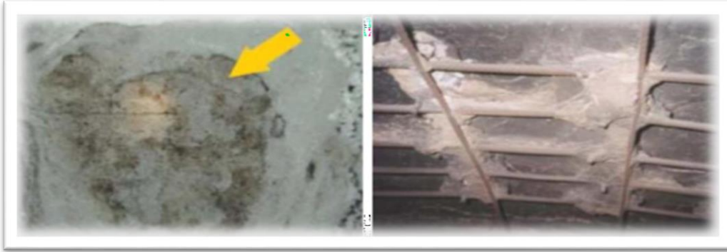
Figure II.17 : Ecaillage lors de l'incendie du tunnel mont blanc. [Saadi,2017] .
