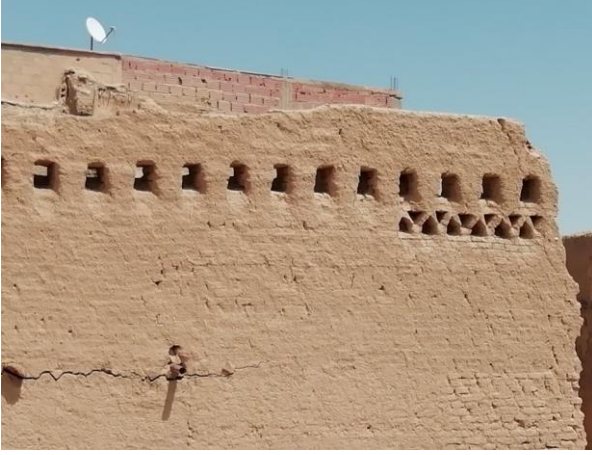
صورة رقم -49:تآكل تليبس الجدران
