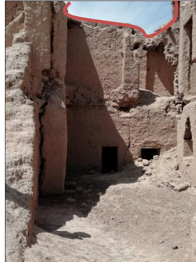
صورة رقم -50:-تآكل رأس الجدران
