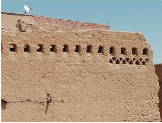
صورة رقم 51:-تآكل رأس الجدران
