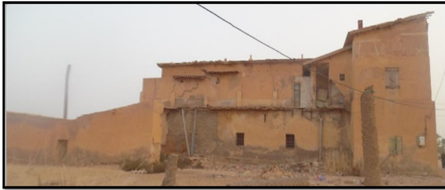
الصورة 94: توضح الجزء المهدم من المبنى الذي يحتاج إلى الترميم
