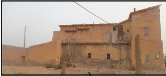
صورة74: تأثر الواجهة الشمالية المصدر: الطالبة 2019 بظاهرة التكثف
