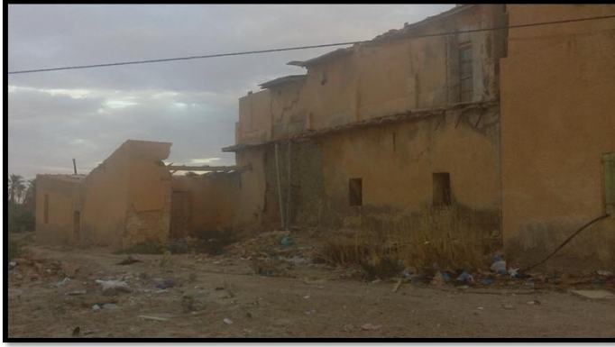
صورة 79: الواجهة الشمالية تأثرها بخطر تعرية الجدران.
