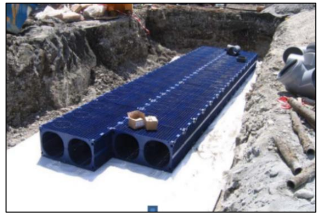
Fig.I.38 : drainage des eaux pluviale
