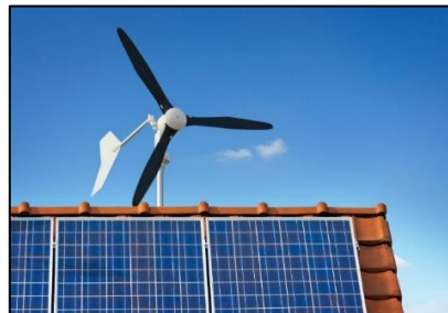
Fig.I.43 : les éoliennes domestique et les panneaux photovoltaïques.
