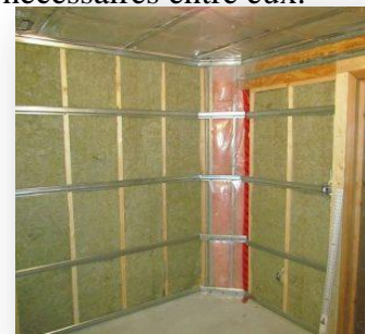
Photo 85: تركيب غرف العزل الصوتي للمولدات الكهربائية: Source : serco-syr.com
