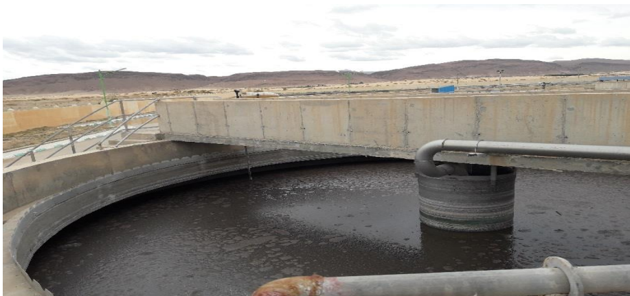
Figure II. 1 : Ouvrage d'épaississement de la STEP de Boussaâda.
