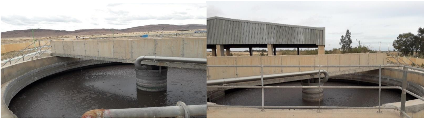
Figure I.12: Ouvrage d'épaisseur de la STEP de Boussaâda.
