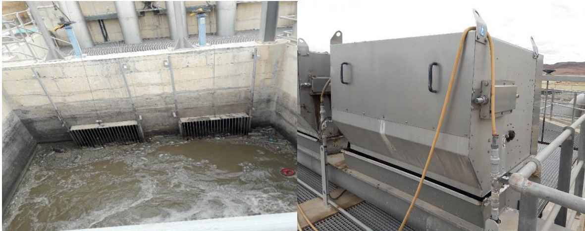
Figure I.5: Dégrilleurs de la STEP de Boussaâda.
