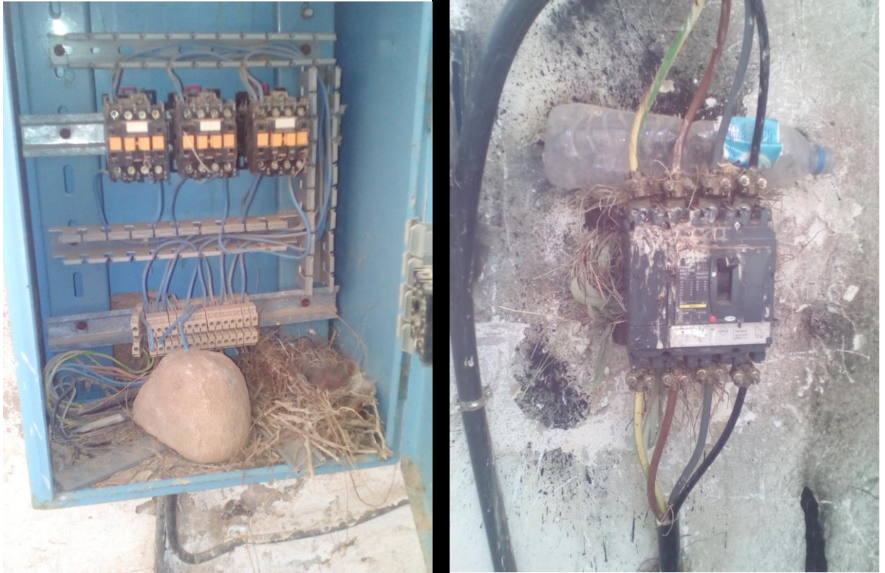
Photo IV.4 : Installation électrique des forages
