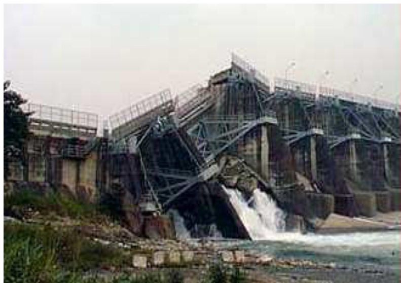
Figure 2.9: Barrage de Shih-Kang après le séisme Chi Chi (Taïwan)
