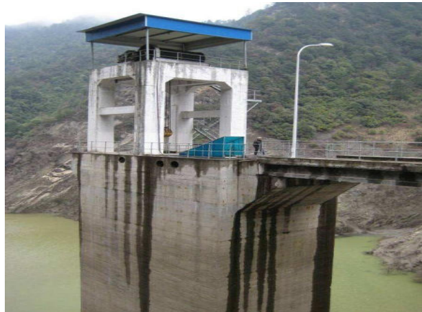
Figure 2.11: Fissures sur le portique de la tour de prise d'eau de Shapai
