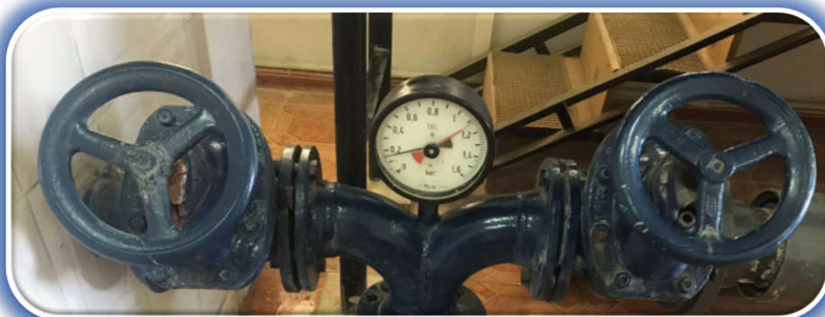
Figure (1.13): Photographie des deux vannes.
