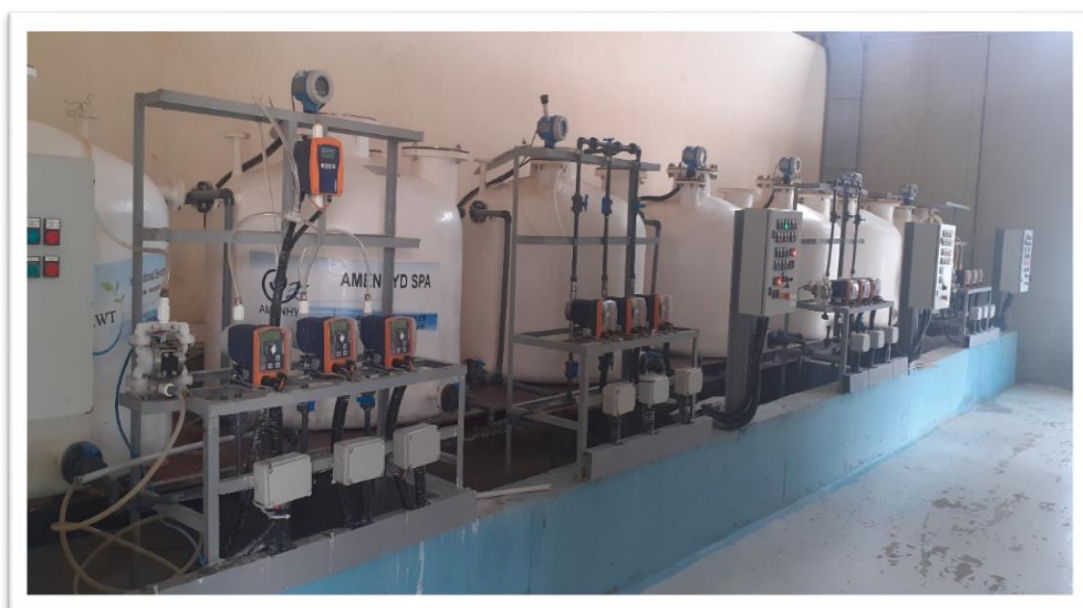
Figure 23 : Postes de traitement chimique
