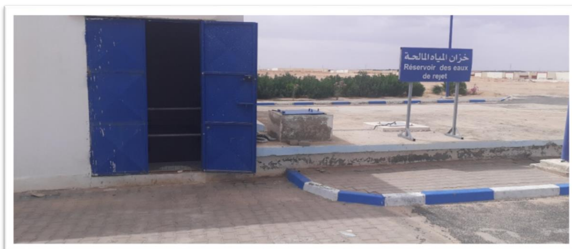
Figure 20 : Bassin des eaux de rejet.
