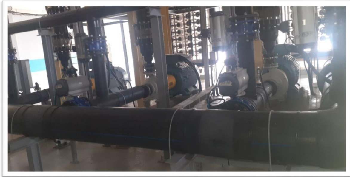
Figure 18 : Les pompes à haut-pression
