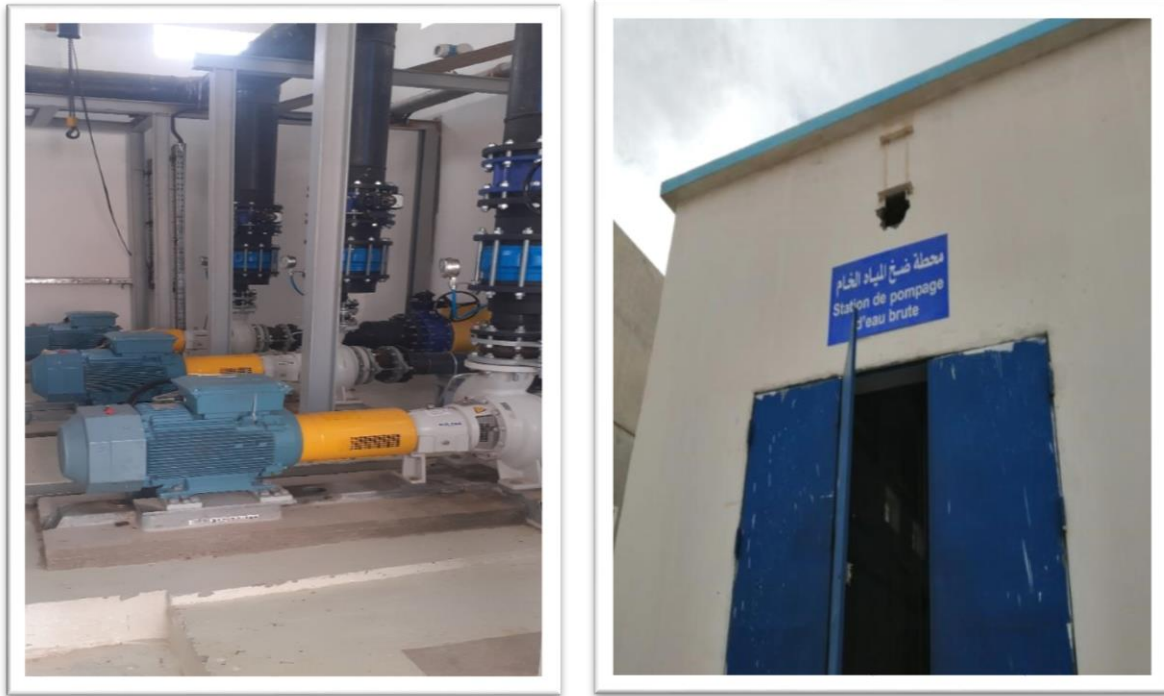
Figure 15 : Pompe d'alimentation des filtres à sables.
