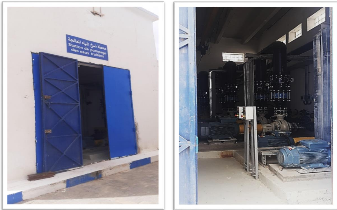
Figure 22 : Station de pompage d'eau traitée
