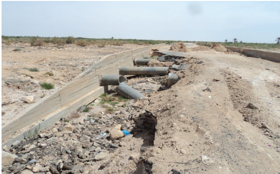
Dégâts au niveau de l'ouvrage de déviation (Séquelle des dernières inondations à Still)
