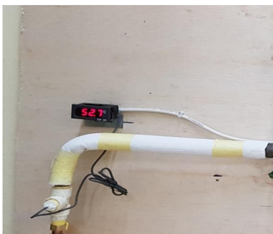
Afficheur de température à la sortie de la cuve de stockage
