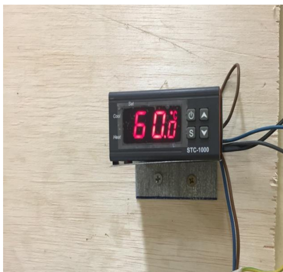
Figure III.7. Thermostat de la température de l'eau chaude.
