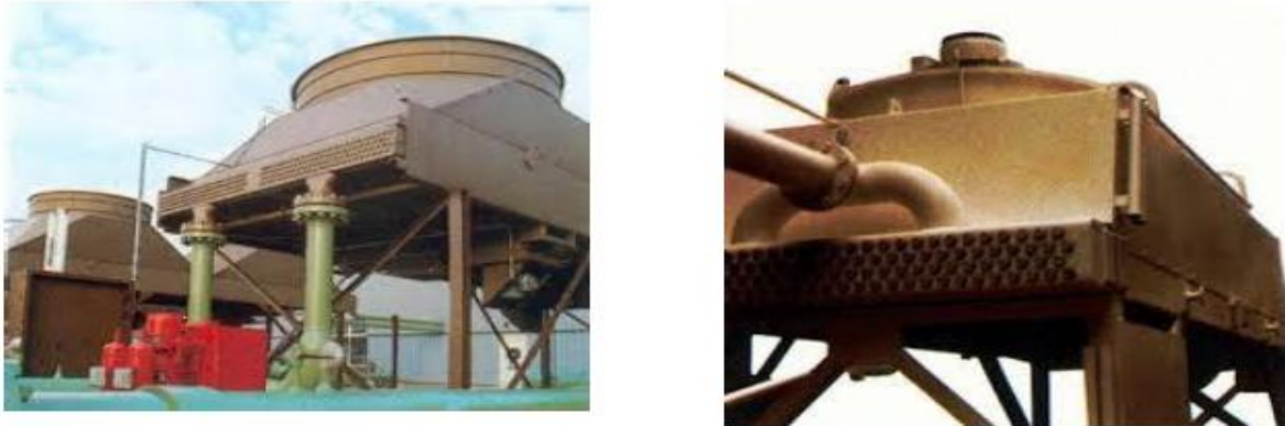
Figure I.13 Aéro-réfrigérant avec vue sur la ligne d'alimentation et bouchons de tube.
