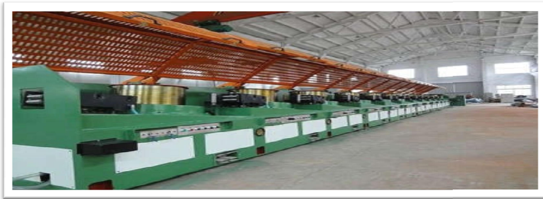
Figure. II.4 : ligne de tréfilage.
