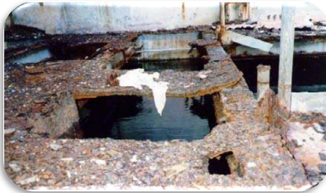
الشكل (1-1) : صورة للتآكل المنتظم
