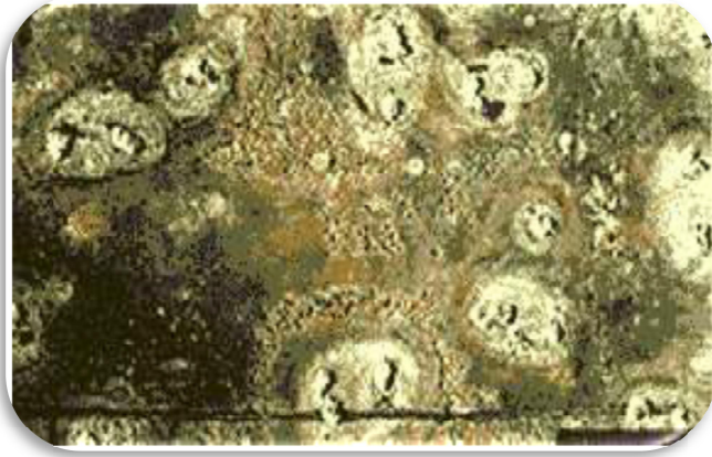
الشكل(1-2): صورة للتآكل بالنقر
